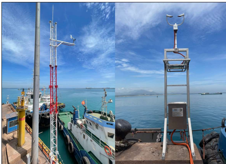
Trạm quan trắc khí tượng thủy hải văn tự động lắp cố định trên bến Cảng Realtime ocean-meteorological monitoring station installed at the seaport
