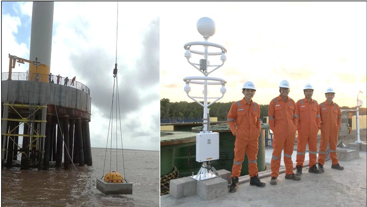
Hệ thống quan trắc thời tiết tự động liên tục tại Trụ điện gió và tại Trạm biển áp (Sub-Station) phục vụ vận hành an toàn trang trại điện gió ngoài khơi Real-time ocean-meteorological monitoring system at offshore wind turbine and at the sub-station for safety operation of the offshore wind farm
